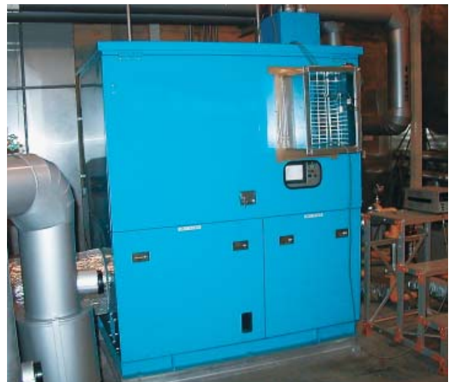
第2図 冷暖房型MGT-CGSの外観
