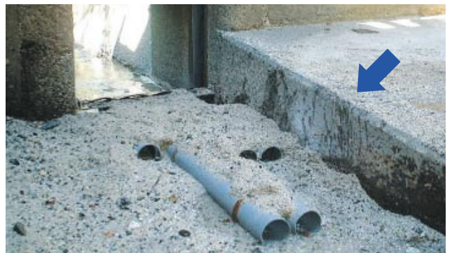
第6図 沈砂池排砂装置現地試験状況
