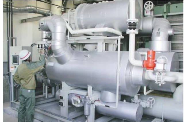
超高効率ヒートポンプ「ウルトラハイエフ」の外観
