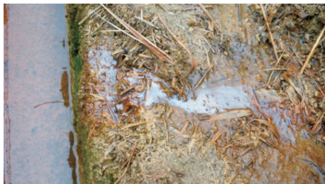
第1図 変電所脇の側溝で見られた光景
