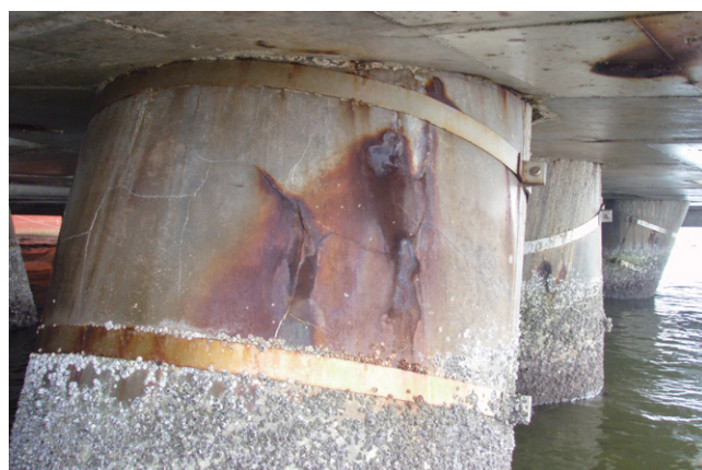
第1図 モルタル被覆部の劣化
