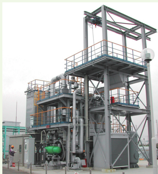
実証設備外観
