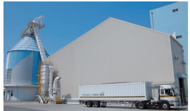
写真2 木質バイオマス混焼設備
