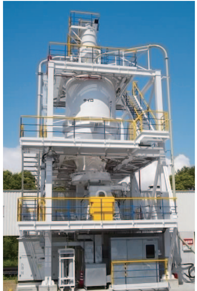
写真4 炭化燃料受入・払出施設(サイロ)
