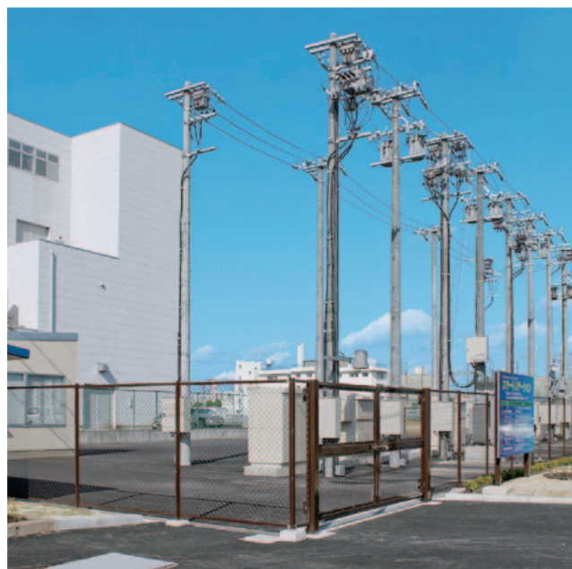
第1図 実証試験設備の外観
