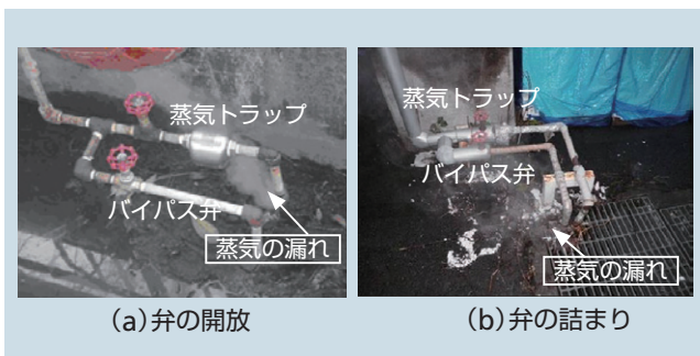
第3図 蒸気トラップの故障
