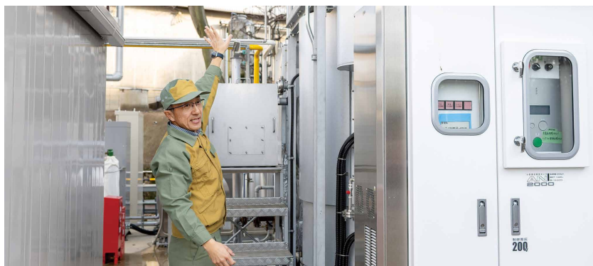
中部電力 技術開発本部構内 アンモニア燃焼試験設備
