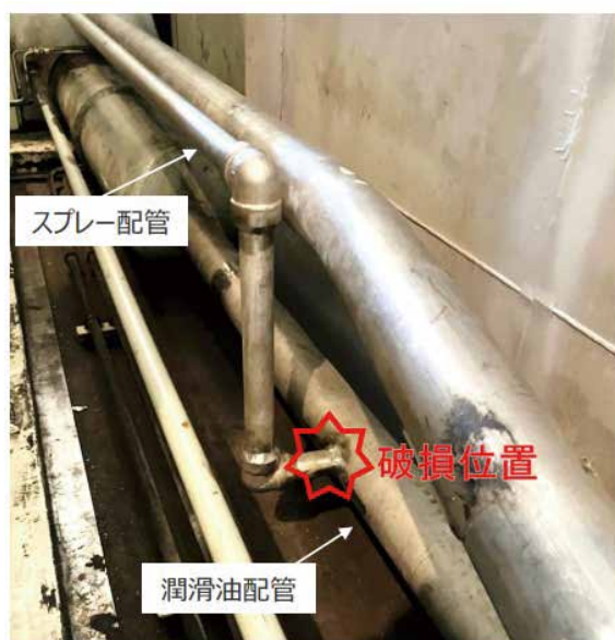
第4図 タービン軸受潤滑油配管
