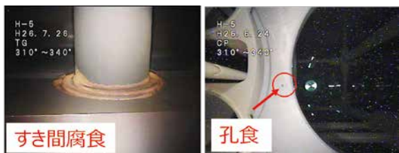
第2図 原子炉内構造物の腐食
