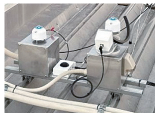
第3図 屋根上の日射計の設置状況
