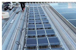
第1図 屋根上の設置状況
