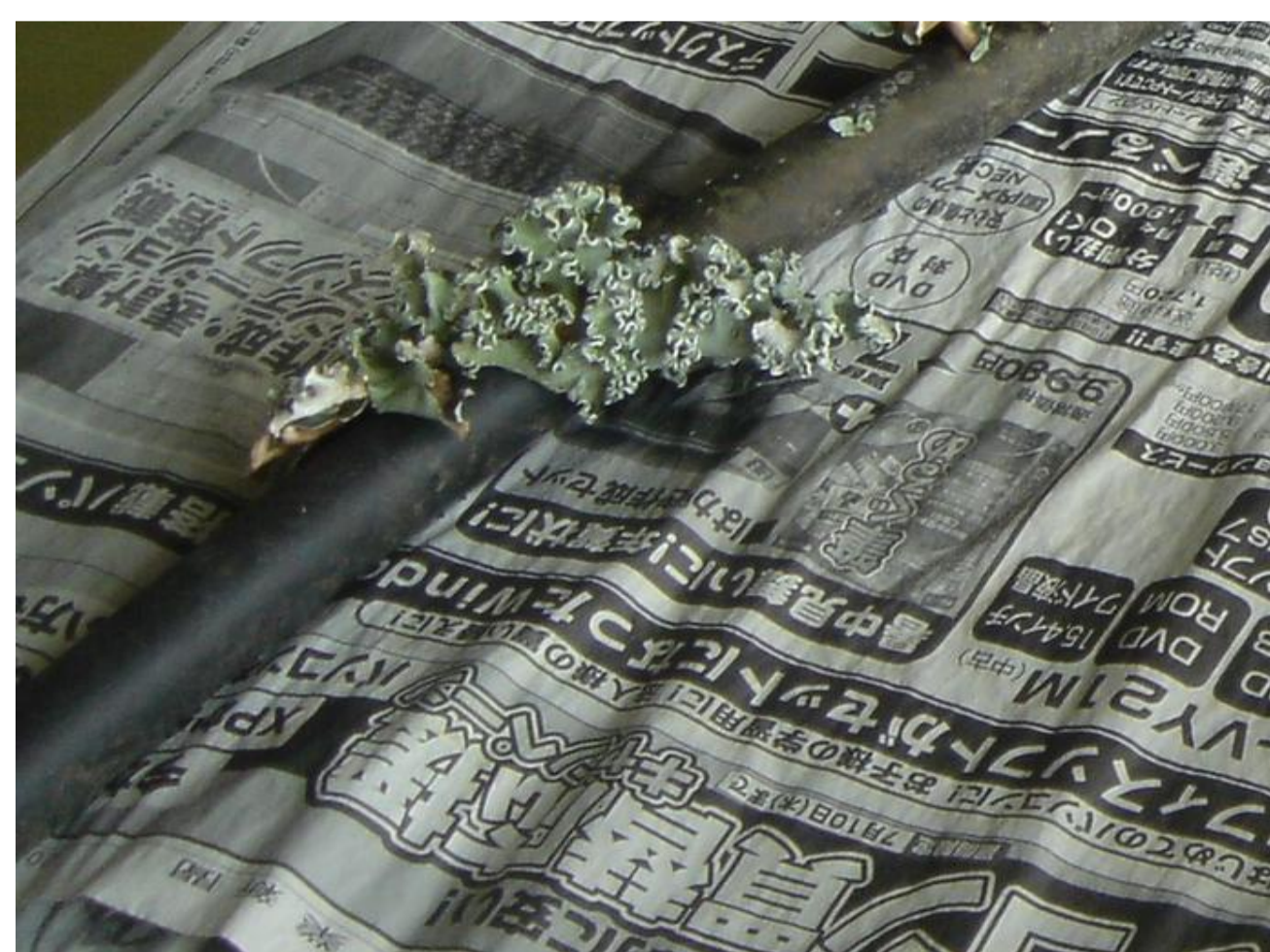
地衣類が発生した電線
