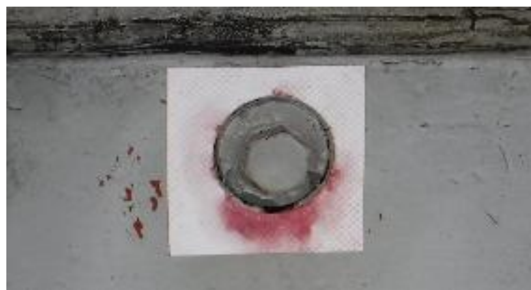
変電設備における漏油検出例
