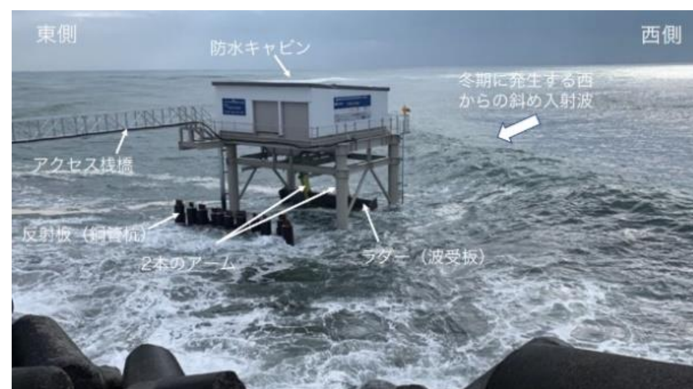
平塚波力発電所
