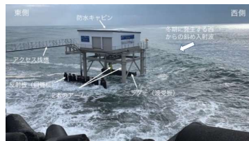
平塚波力発電所
