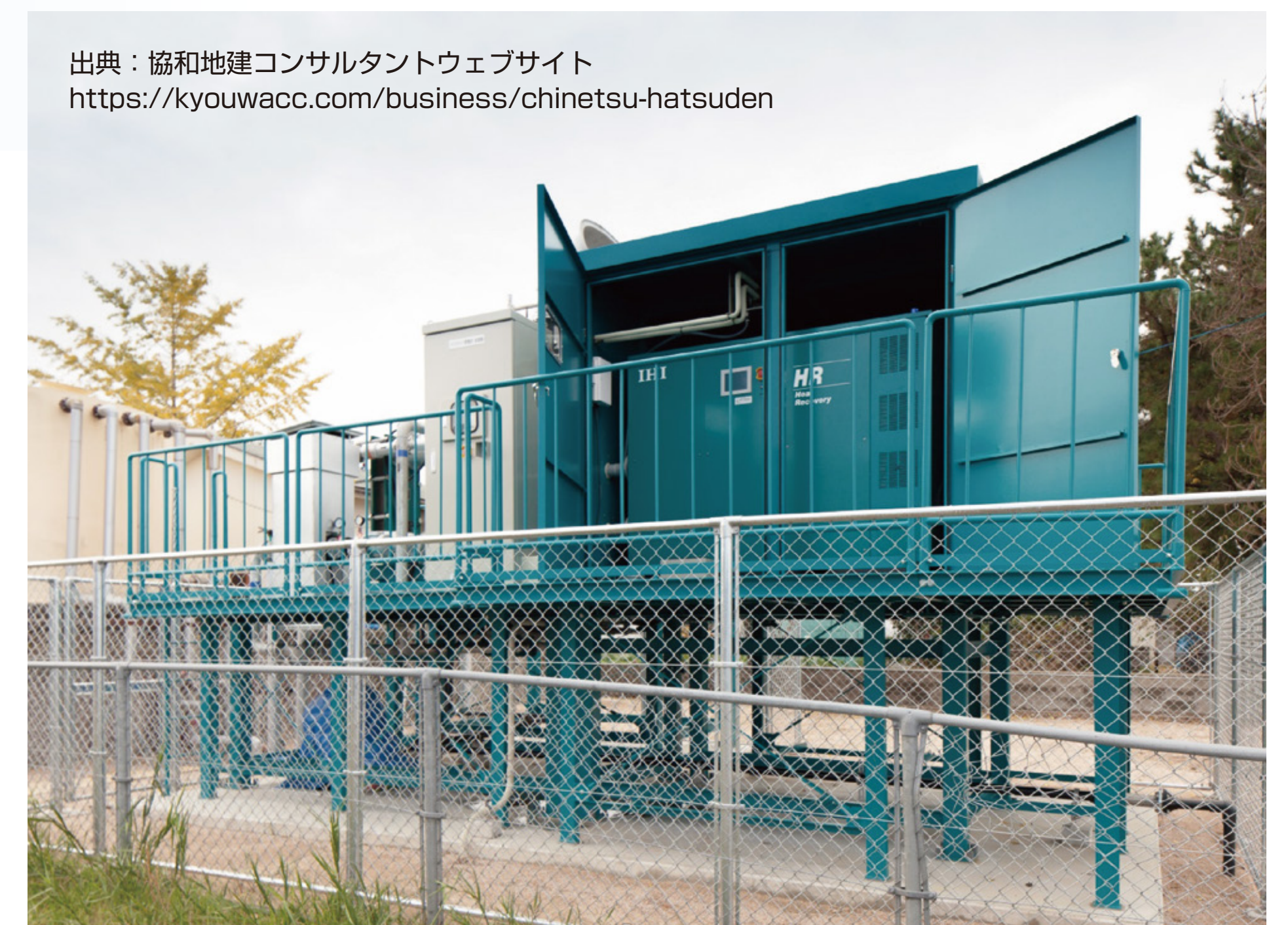
▲GeoShink 実証試験先の湯梨浜地熱発電所
