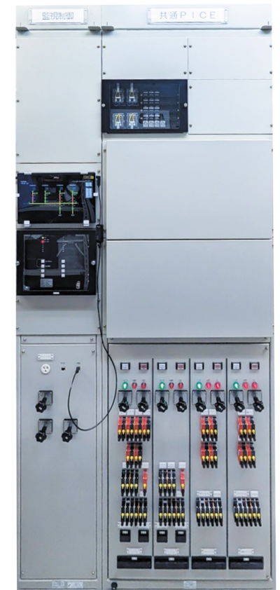
監視制御盤・共通PICE盤
