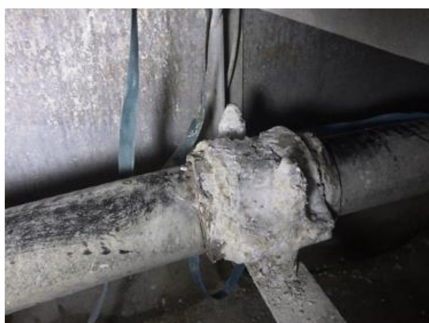
腐食したクリート
