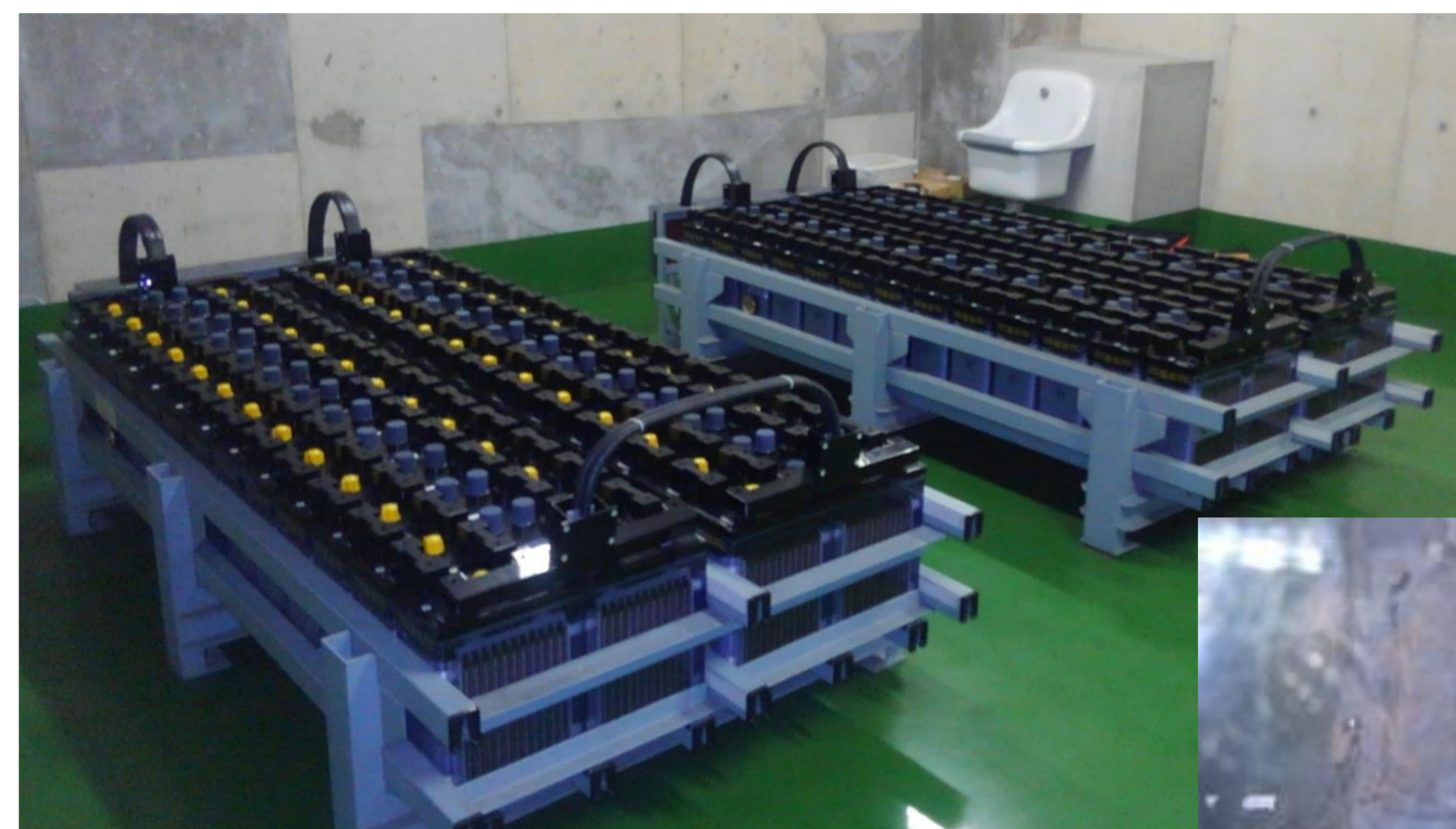
変電所鉛蓄電池
