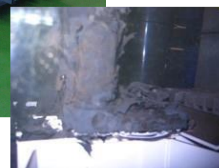
陽極鉛部はく離の状況
