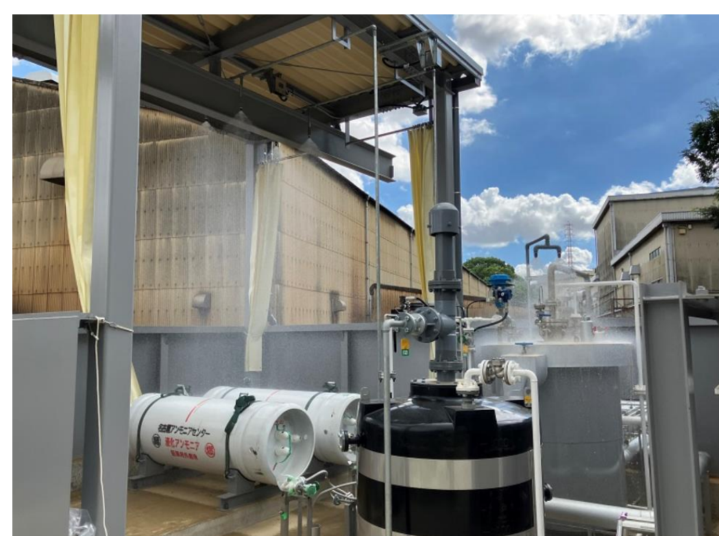
散水設備の試運転の様子
