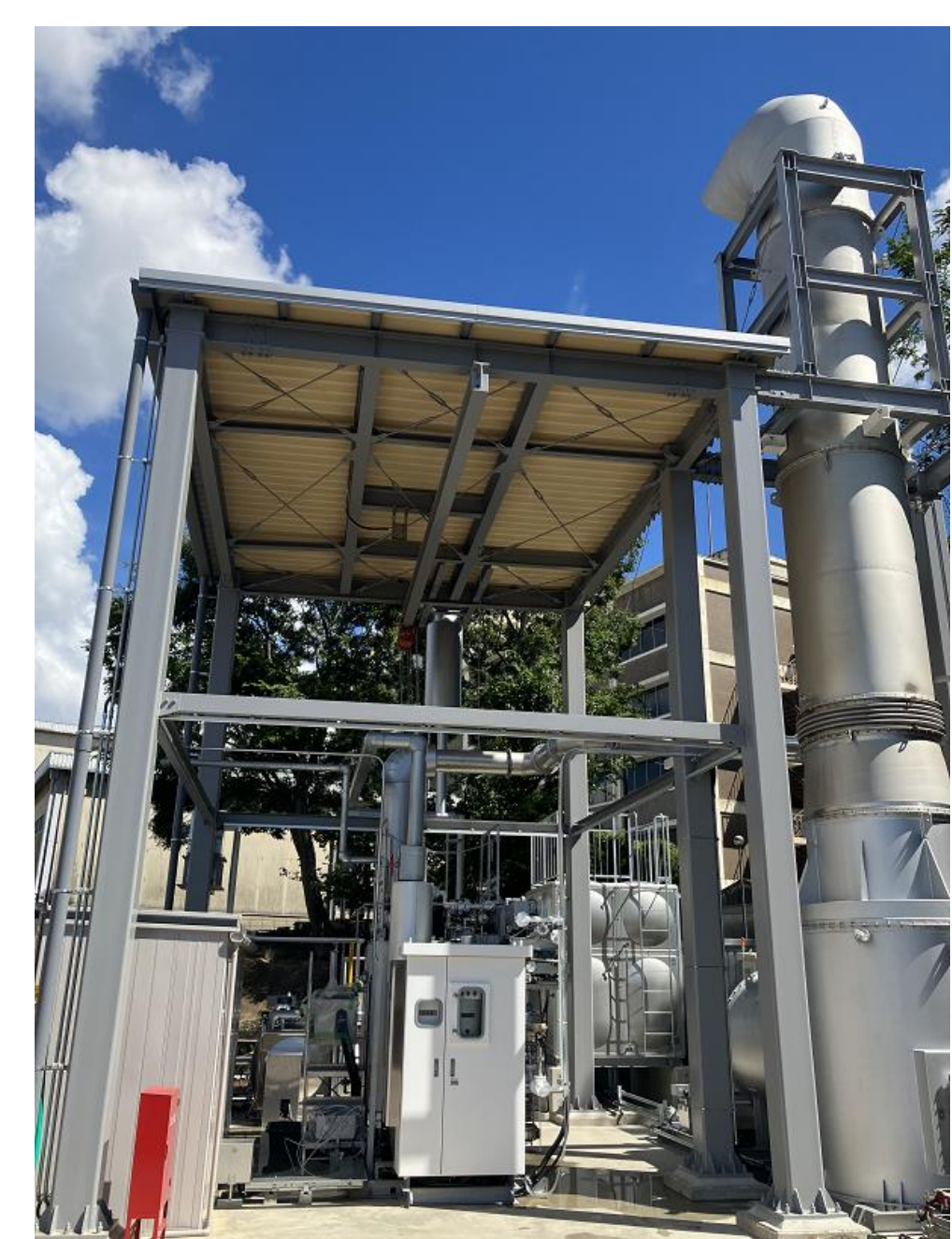
アンモニア燃焼試験設備
