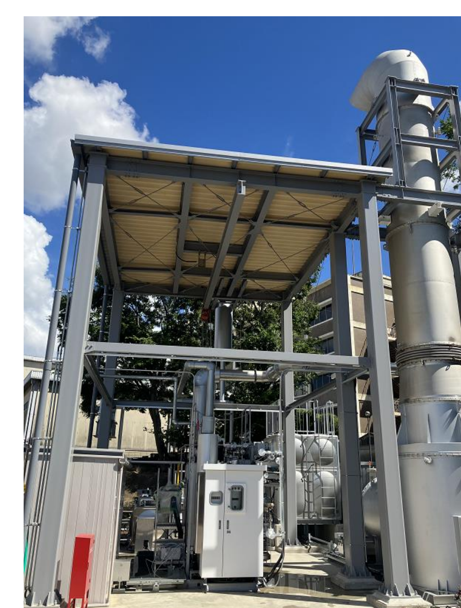
アンモニア燃焼試験設備
