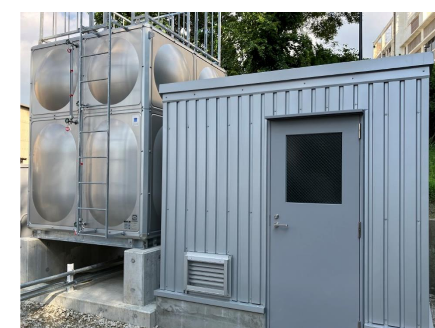
散水ポンプ置場と貯水タンク
