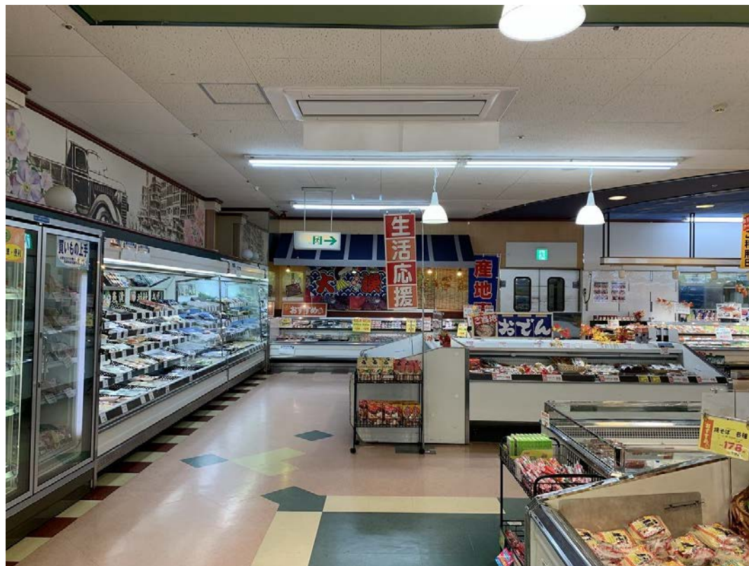
＜小売店舗（空調・ショーケース）＞
