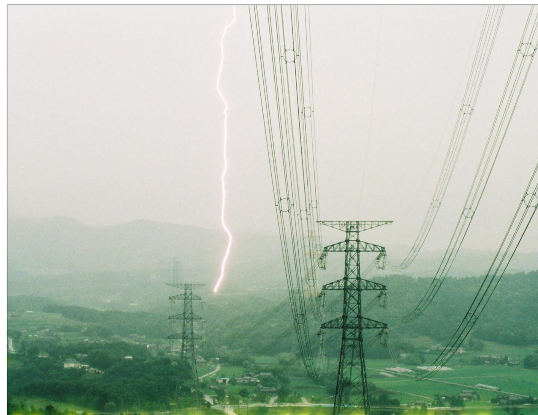
500kV送電線への落雷様相観測
