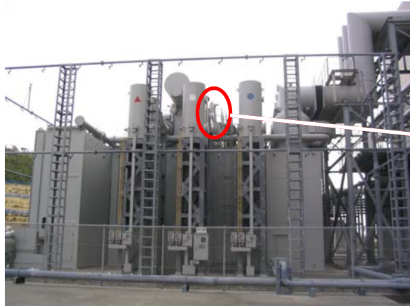
主要変圧器全体写真
