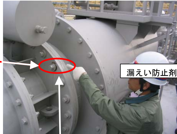
油がしみ出している箇所
