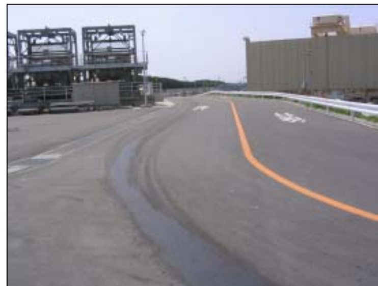
漏えい跡の例
