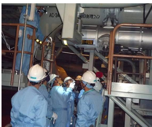
素ポンベによる格納容器ベント弁の作動確認の様子
