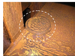
【脱落したエンドキャップ】
