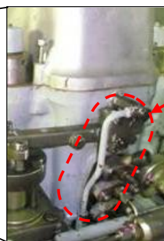
シリンダと潤滑油配管の接続部
