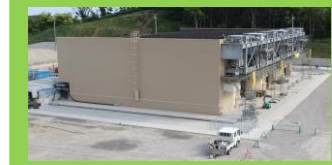
ガスタービン発電機
