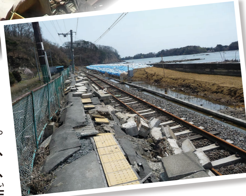
東日本大震災 陸前高田駅の被害の様子 写真提供: 一般財団法人消防防災科学センター
