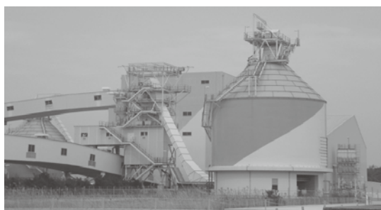
バイオマス燃料設備(碧南火力発電所)
