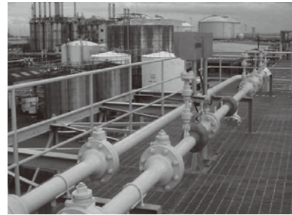
ガス供給設備
