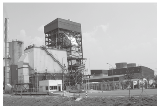
籾殻発電設備(タイ国北中部ピット県)
