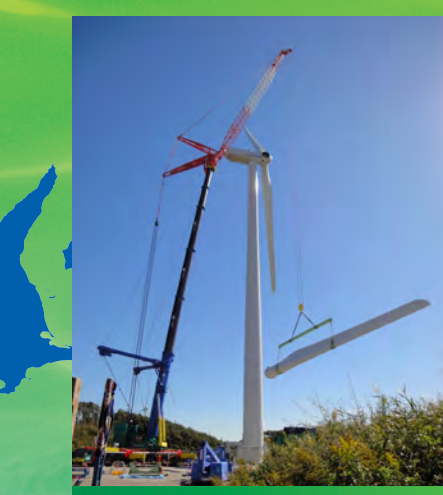
御前崎風力発電所(静岡県)建設当時 ブレード設置の様子
