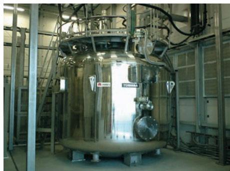
SMES (10,000kW 1秒間補償)装置
