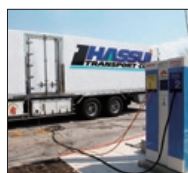
外部電源式アイドリングストップ給電スタンド
