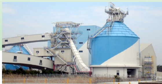
バイオマス燃料設備 (碧南火力発電所)
