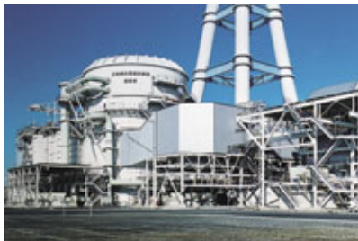
碧南火力発電所における排煙脱硫装置
