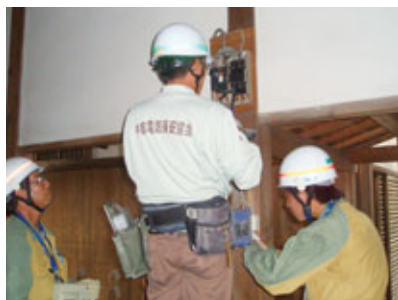
曼陀羅寺(愛知県江南市)の電気配線診断(中部電気保安協会と合同で実施)
