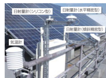
営業所屋上に設置した日射量などの測定装置と既設の太陽光パネル
