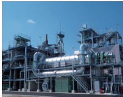
衣浦東部浄化センター 燃料化施設
