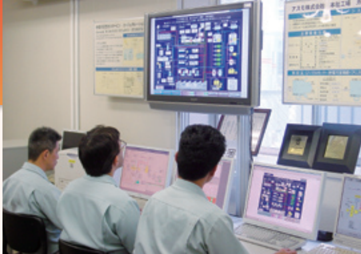
アスモ(株)様の監視室
