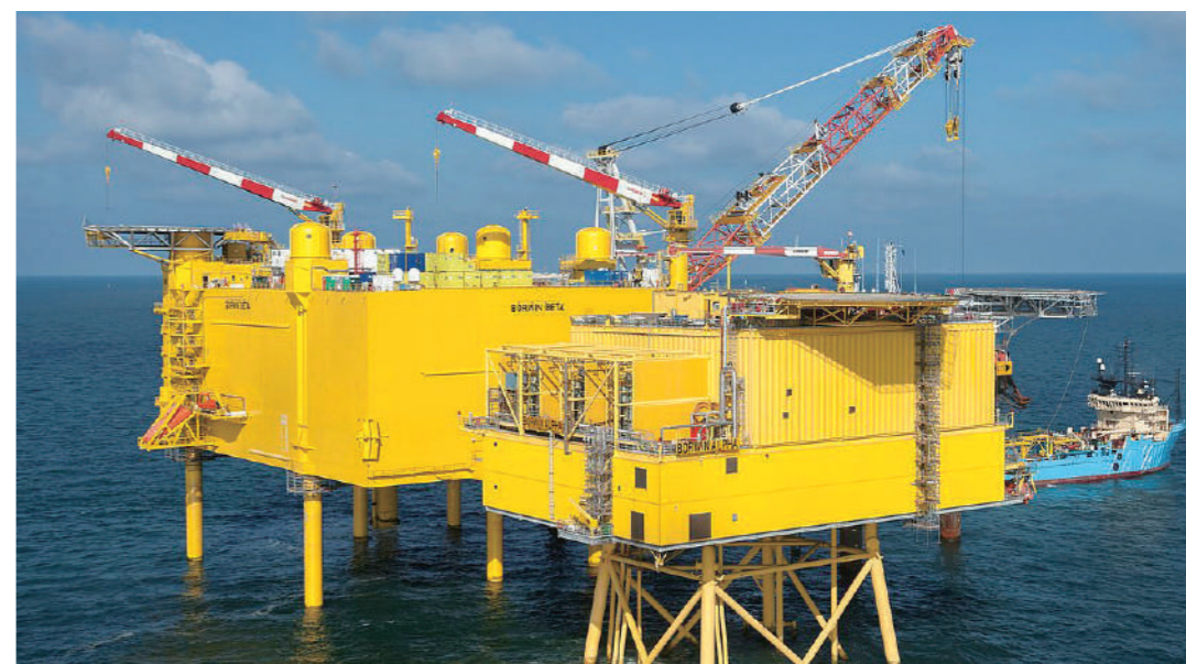
▲ドイツ 洋上に設置された交流直流変換設備
