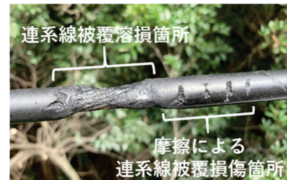
写真1 当該連系線の損傷状況
