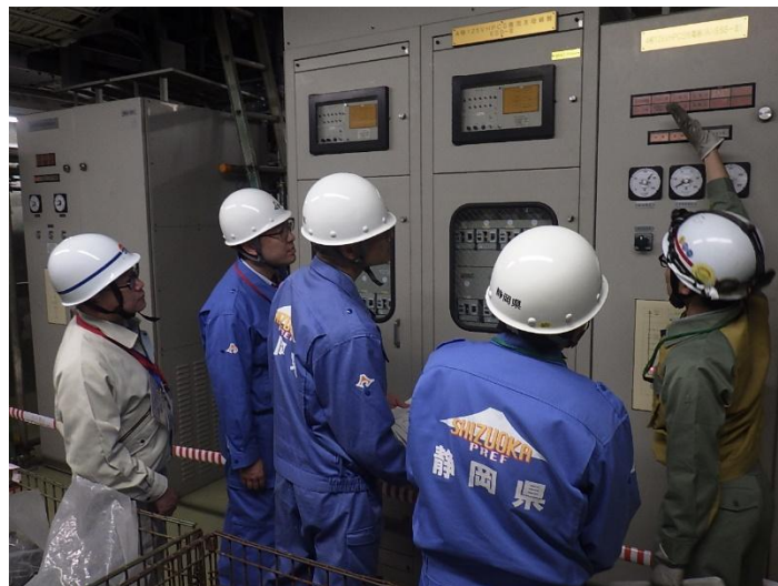
蓄電池容量の増強のうち高圧炉心スプレイ系蓄電池容量の増強工事 状況確認の様子
