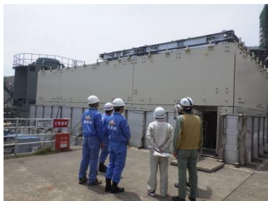
竜巻対策(海水取水ポンプおよび同ポンプ周辺の配管に対する飛来物防護対策)点検の様子
