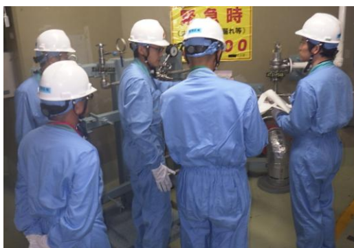
格納容器ベントの遠隔操作に係る設備 点検の様子
