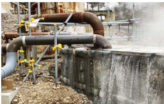
発電所から中尾温泉へ供給している熱水
