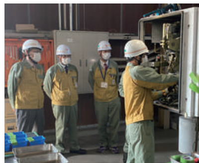
トヨタ生産方式を通じた 変電機器点検業務のかいぜん活動
