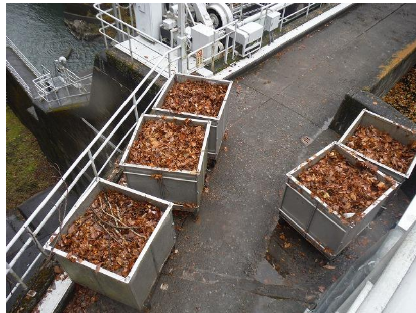
除塵機で除去した落ち葉 (10月の除去量19m 3 )
