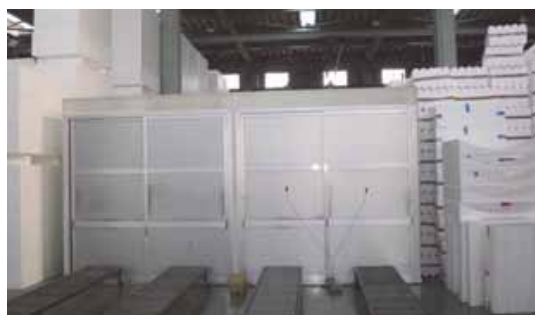
第2図 A工場の乾燥用熱風炉の外観
