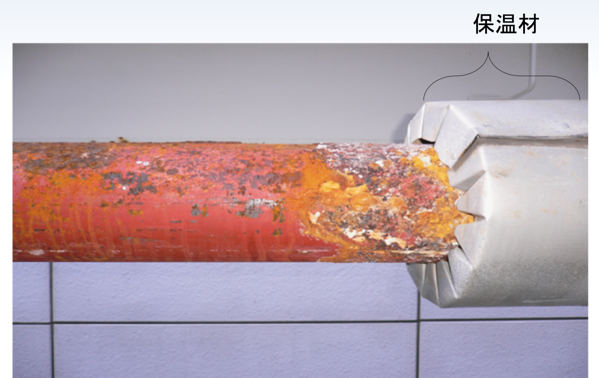
屋外配管の外面腐食事例
