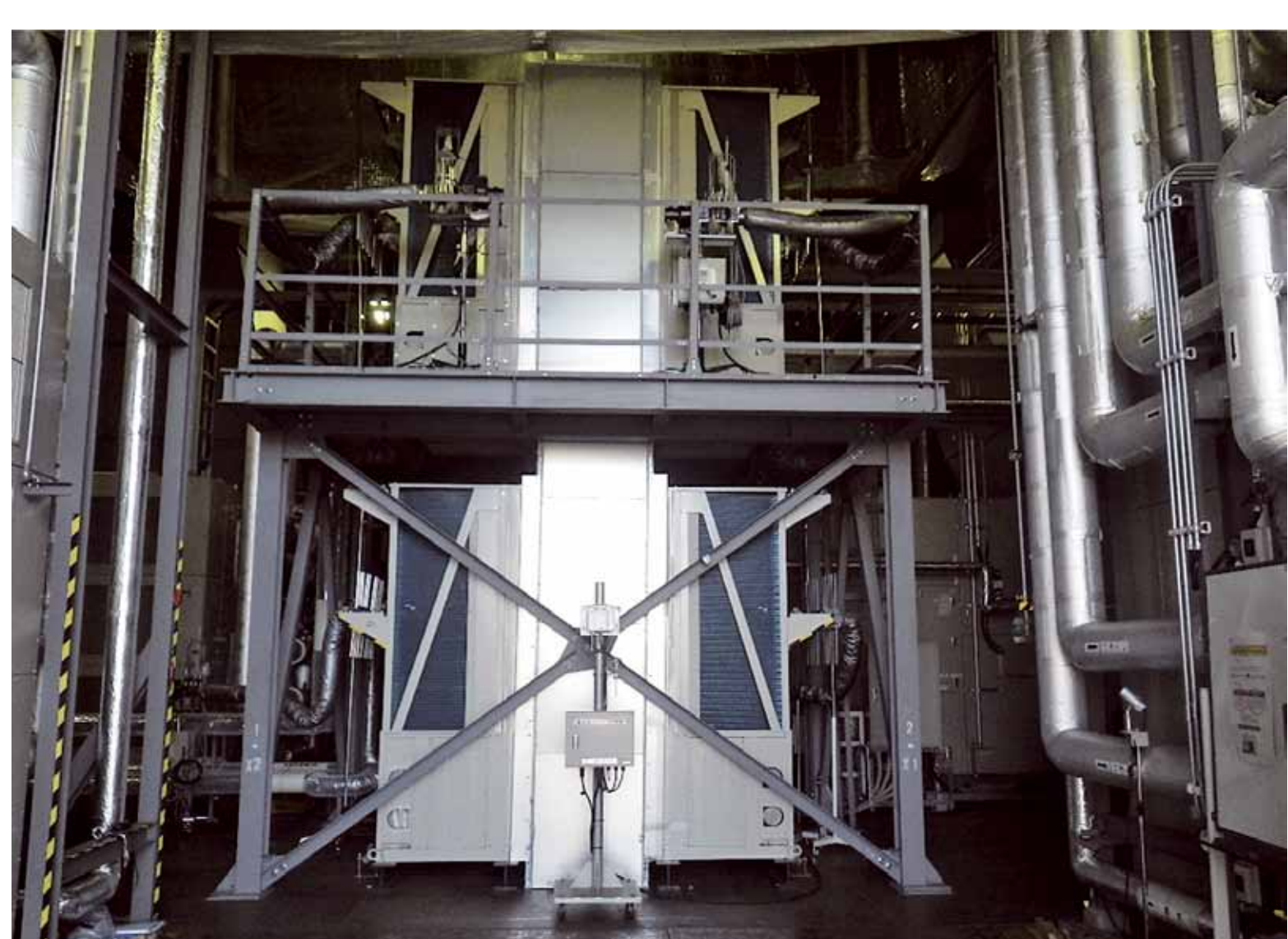
2段積み設置の状況 (100HP: 下段30HP×2台、上段20HP×2台の場合)
