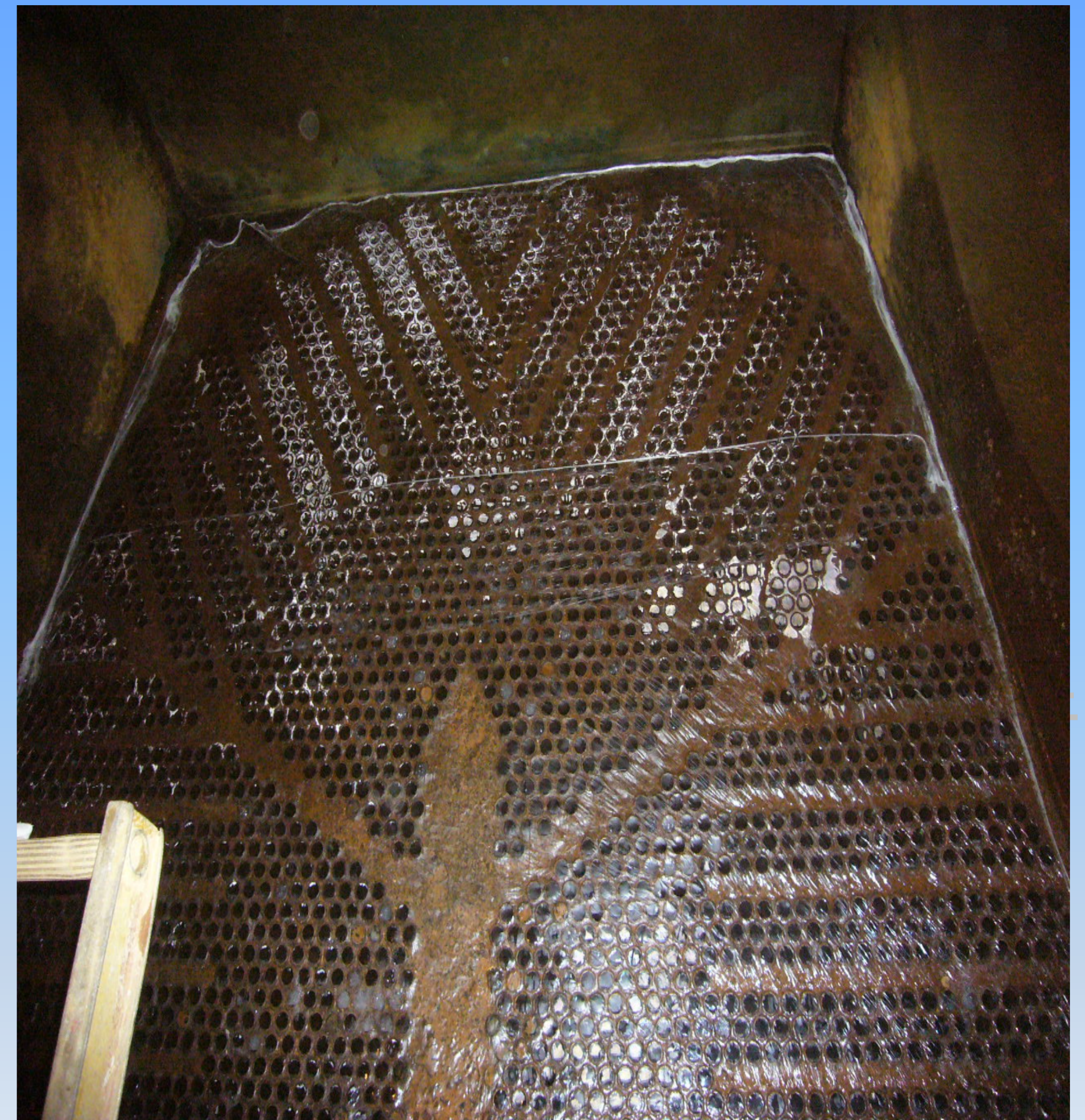
復水器漏えい細管特定状況：渥美火力3号機 (管板面に薄いフィルムを貼った状態)
