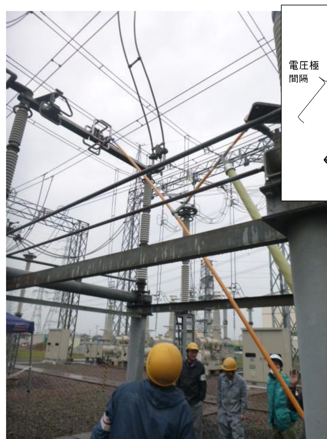
275kV向け測定試験
