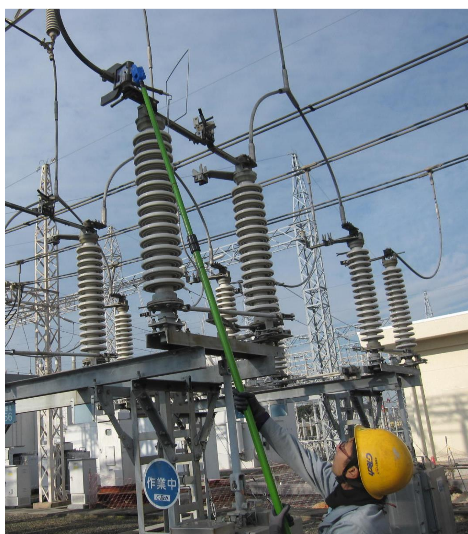
77kV向け測定試験
